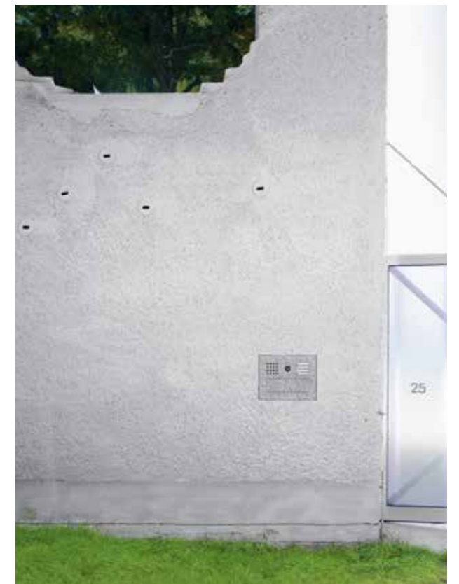
Brandhuber gibt Geschichte, Zeitlichkeit und Aneignung einen eigenen Wert in seiner Architektur. Im Erhalt der Gebäudehülle mit dem typischen DDR-Putz findet diese Haltung ihren geradezu symbolischen Ausdruck.
